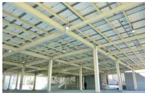
■ 承德陽光活力廣場之太陽能板直接架空以提高透光率
